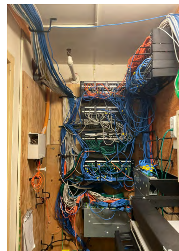
Existing Conduit Sleeve.
