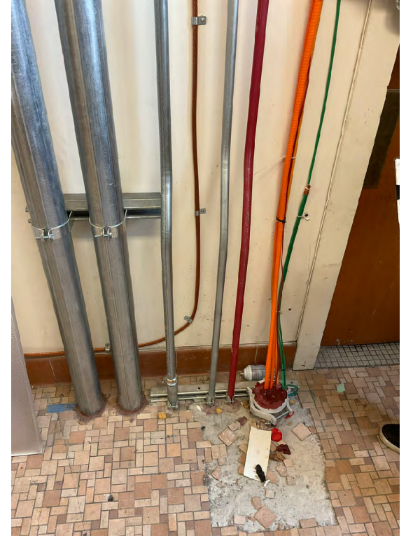
Existing Conduit Sleeve.
